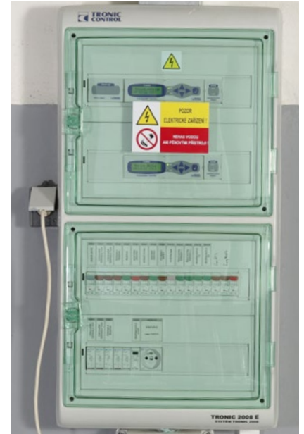
Zabezpečení kotelny podle legislativy podléhají kotelny nad 100 kW výkonu.
